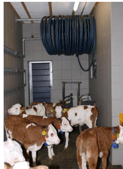
Kälberabteil mit Tränkestand, Wasseranwärmung und Porendecke.
